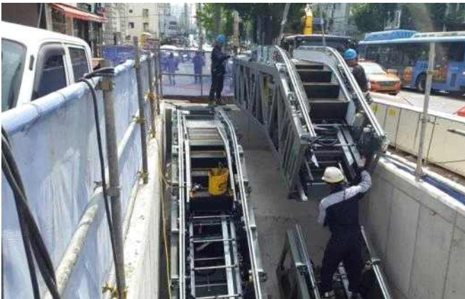
〈 편의시설(E/S 등) 설치 〉
