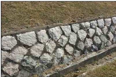
석축 파손(용미리 묘지)
