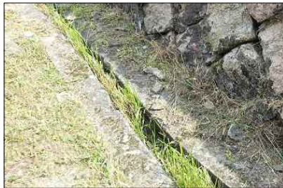
배수로 파손(용미리 묘지)
