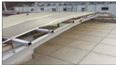
옥상 캐노피 마감재 탈락(승화원)
