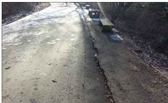
아스콘포장 파손(망우리 묘지)
