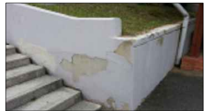
옥외벽식 도장면 탈락(용마리묘지)
