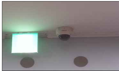
분묘식 추모의집 CCTV
