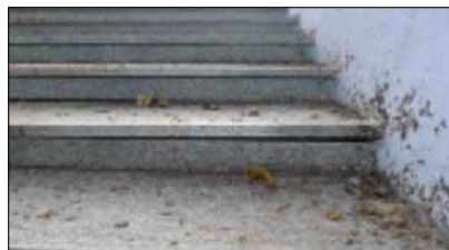
옥외벽식 계단 들뜸(용마묘지)
