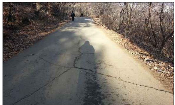
아스콘포장 파손(망우리 묘지)
