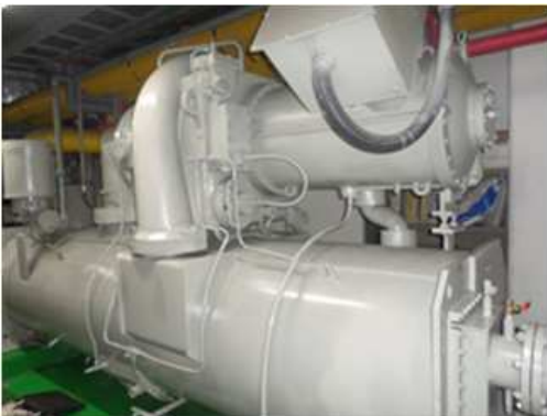
용역명 시청광장 터보냉동기 외부도색 및 정비
