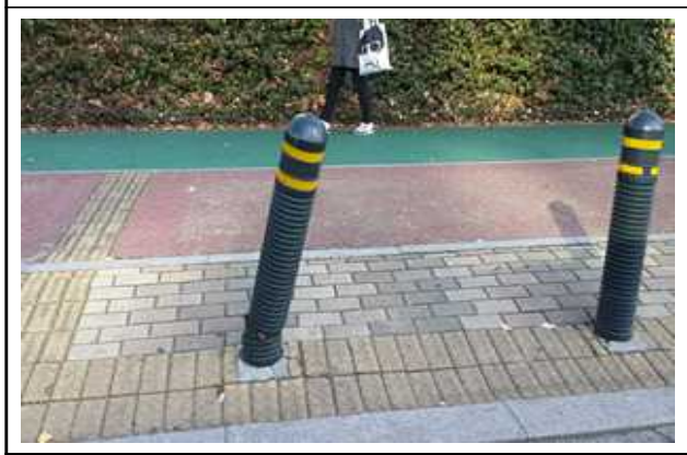
삼성로 한보맨션105동 앞 블라드 파손
