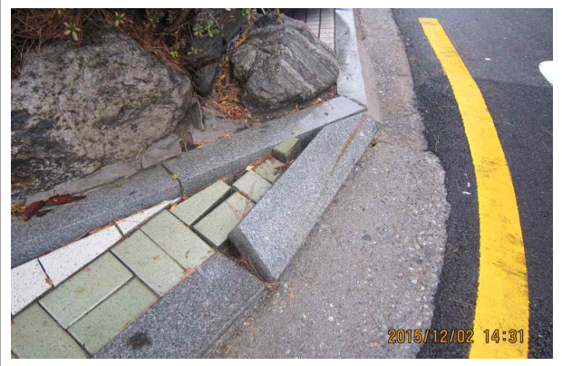
보도블럭 및 경계석 파손
