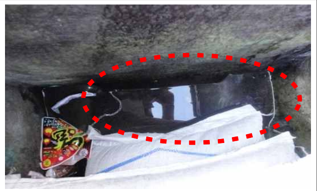
제설제 보관함 내 물고임
