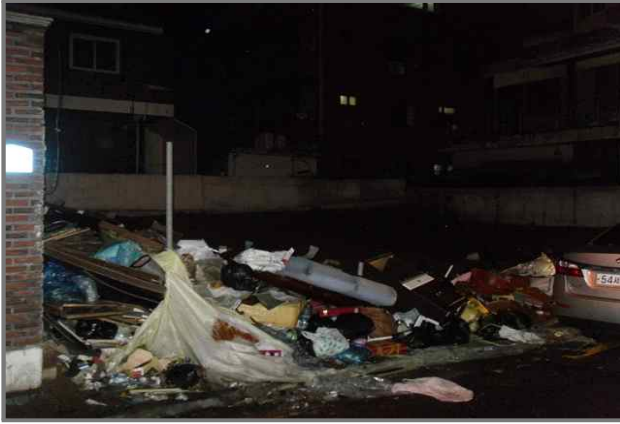
13 위치 간고량로13길 35 (중곡1동 221-4) 내용 철거 가림판 미설치 (건축과)
