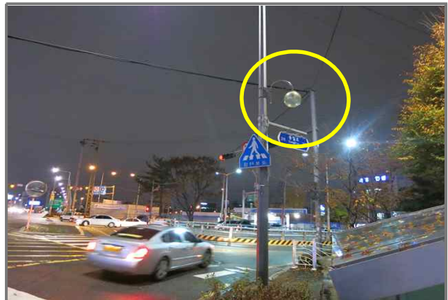
18 위치 천호대로 499 (중곡1동 612-7) 내용 가로등 부점등 (도로과)
