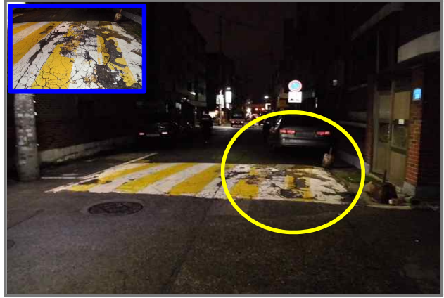
26 위치 능동로43길 20 (중곡1동 242-36) 내용 도로 훼손 (도로과)
