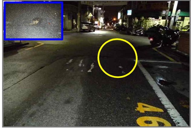
14 위치 능동로43길 34 (중곡1동 243-33) 내용 도로 파임 (도로과)
