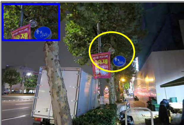
17 위치 천호대로 525 (중곡1동 638-4) 내용 가로등 부점등 (도로과)
