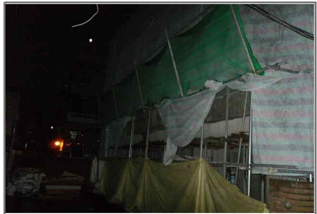
16 위치 능동로41길 6-7 (중곡1동 162-6) 내용 가림막 훼손, 공사안내문 미설치 (건축과)
