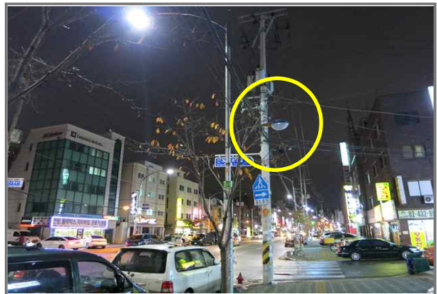
24 위치 긴고랑로 6 (중곡1동 249-28) 내용 가로등 부점등 (도로과)
