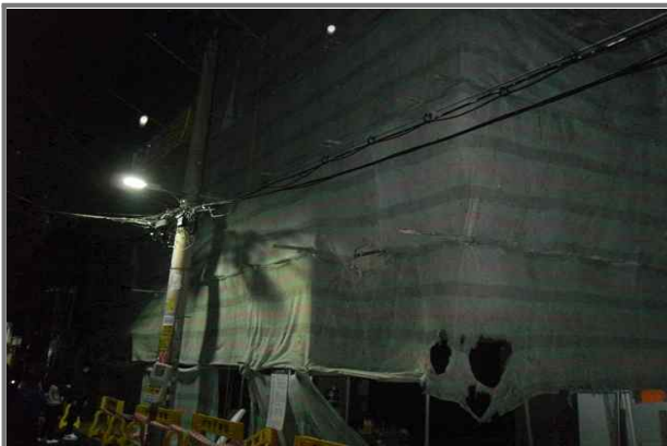
긴고랑로3길 13 (중곡1동 234-17) 가림막 훼손, 낙하물 방지망 일부 설치
