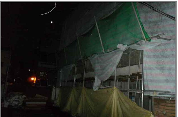
능동로41길 6-7 (중곡1동 162-6) 가림막 훼손, 공사안내문 미설치
