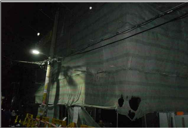
3 위치 긴고랑로3길 13 (중곡1동 234-17) 내용 가림막 훼손 낙하물 방자망 일부 설치 (건축과)
