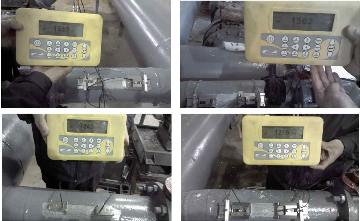
[그림3-2] 제1펌프장 급수 및 잡용수 펌프 유량측정사진
