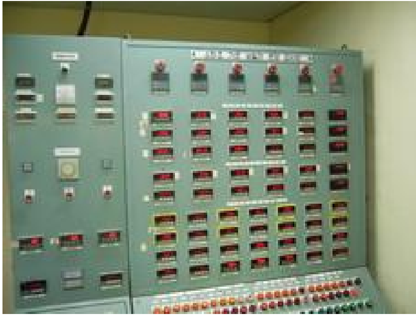
<소화조 가온용 순환펌프 제어반>
