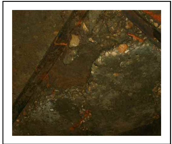
<사진3.2-4> 상부슬래브 조골재 표출 상태
