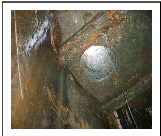
<사진3.2-2> 상부슬래브 및 벽체 노후화 진전 상태
