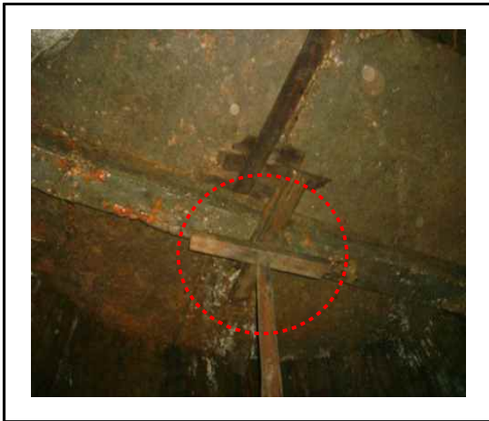
<사진3.2-3> 벽체 마감부 균열 및 노후화 진전상태
