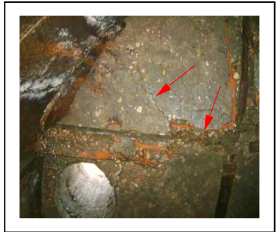
<사진3.2-6> 상부슬래브 균열 및 골재분리 상태
