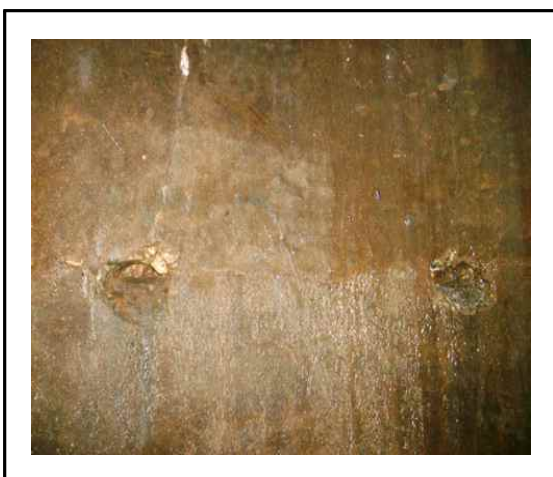
<사진3.2-7> 벽체 마감부 박락 및 노후화 진전
