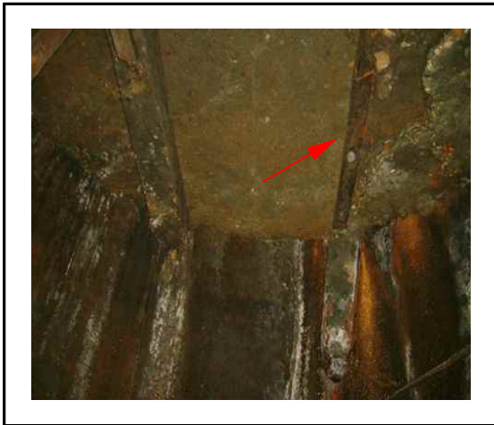
<사진3.2-5> 가로보 탈락(기능상실)상태
