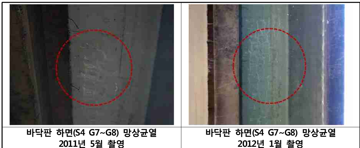
<그림 3.2> 바닥판 슬래브 손상 진전현황
