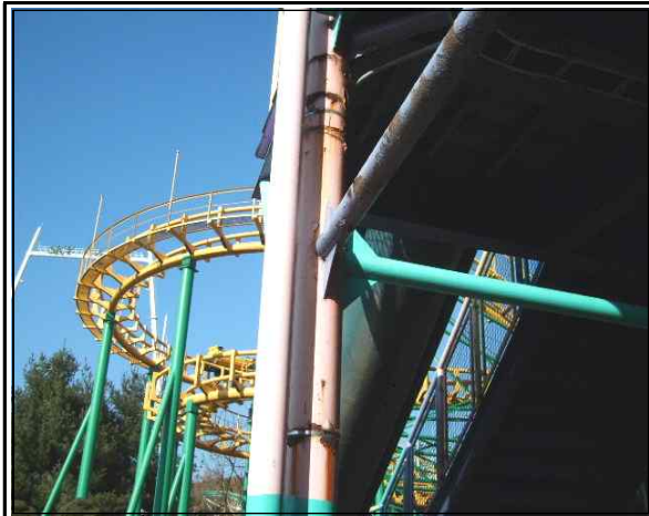
<사진 5-23> 강관기둥 도장 들뜸 및 녹 발생 현황
