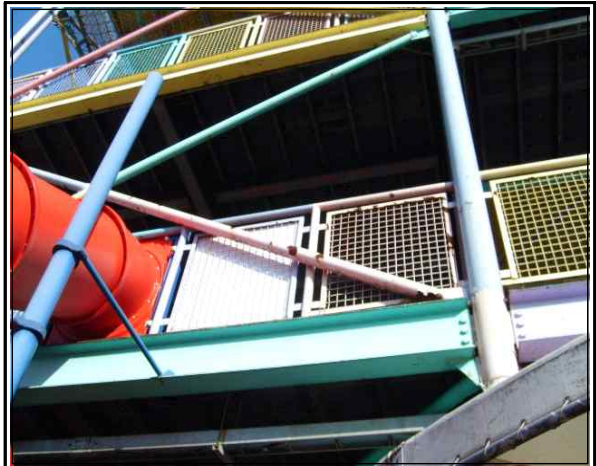
<사진 5-24> X브레이싱 도장 들뜸 및 녹 발생 현황
