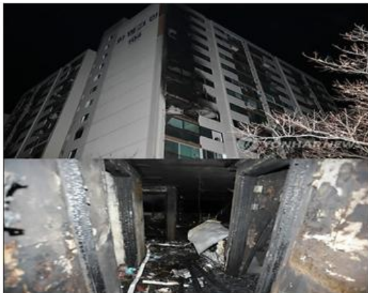
화재 진화 후 건물외부 그늘음과 내부 화재흔적
