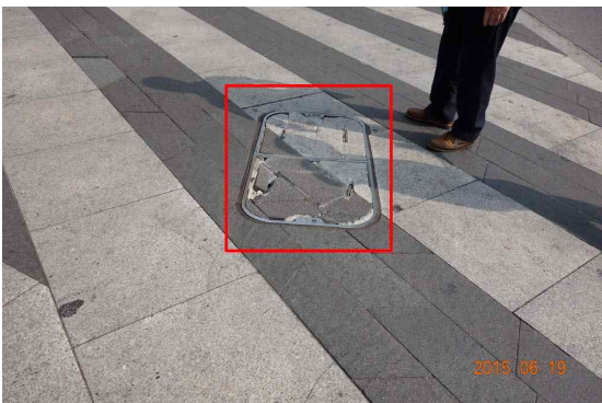
감사담당관 - 강남대로 통신 맨홀 파손
