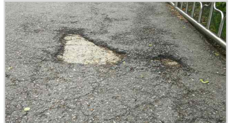
도로 파손 (응봉산 근린공원)
