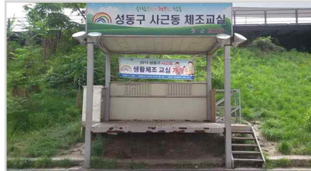
생활체조교실 스탠드 부식 (사근체육공원)
