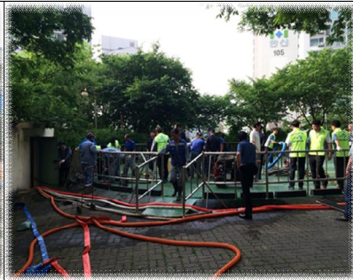
2014. 상도동 건영아파트 기계실 침수 배수작업 지원
