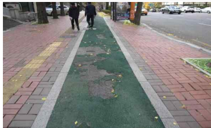
중구 동호로 자전거도로 파손
