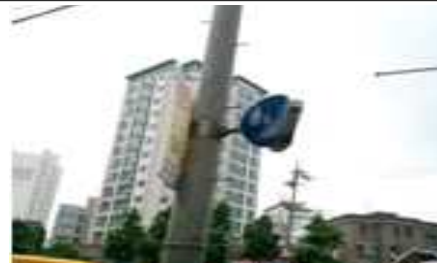
은평구 진흥로 안전표시 파손
