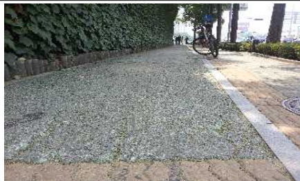
노원구 노해로 자전거도로 파손
