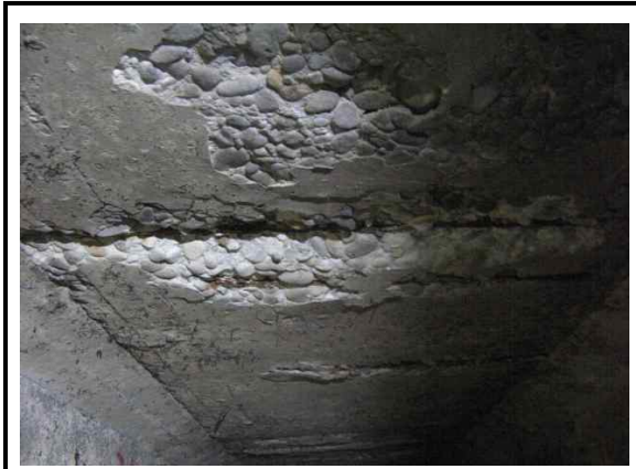
사진 1 상부슬래브 현황내용 1-1 구간 박락, 철근노출
