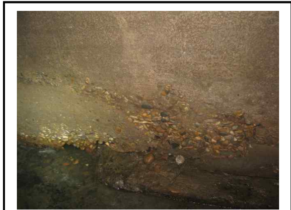
사진 4 벽체 현황내용 2-10 구간 재료분리
