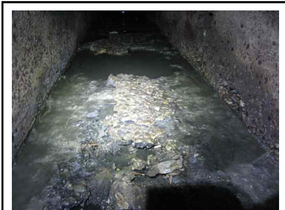
사진 3 바닥 현황내용 1-5 구간 콘크리트 박락
