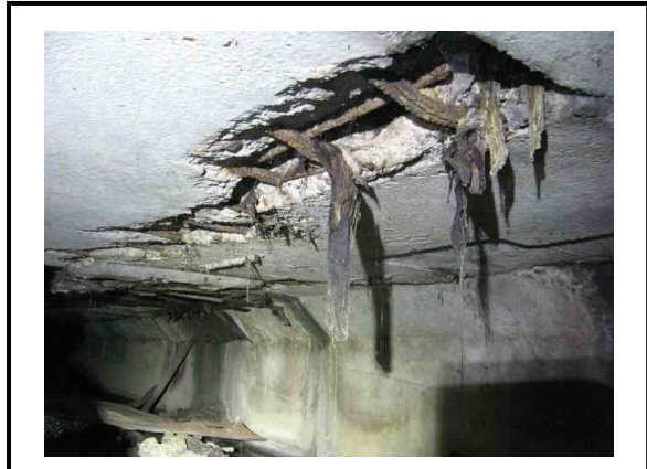
사진 2 상부슬래브 현황내용 1-3 구간 보수부 파손
