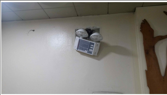
조치전 : (생명) 지하1층, 6층 비상경보등 고장
