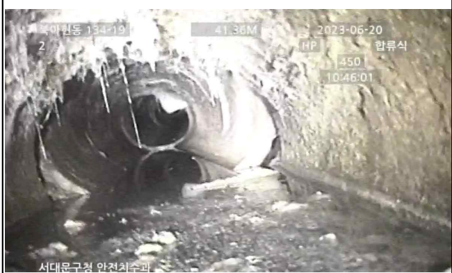
관로 이음부 파손
