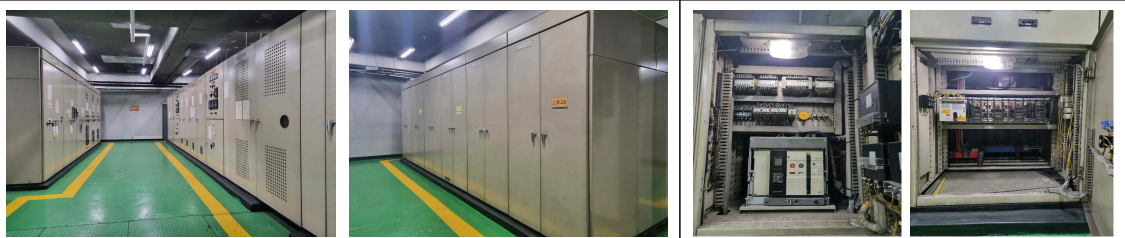
종묘공영 주차장 전기실 전경
