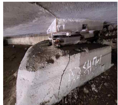
<받침몰탈파손(A 2 SH 7 , 신내)>
