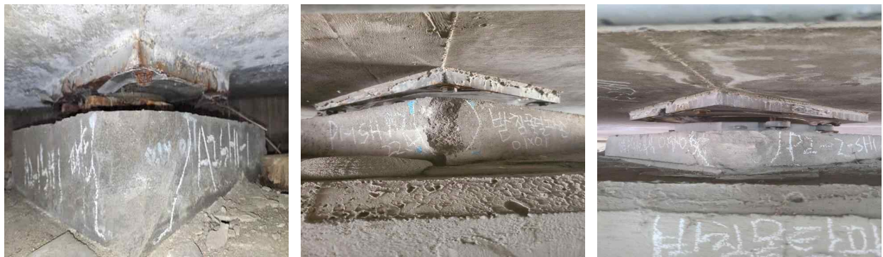
<몰탈 모서리파손(A 2 SH 1 , 신내)> <몰탈 모서리파손(P 1-1 SH 1 , 신내)> <몰탈 모서리파손(P 2-2 SH 1 , 화랑)>
