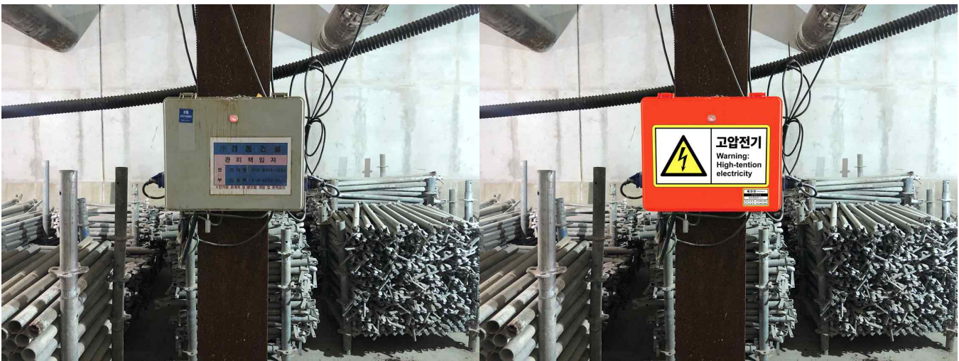
▲ 빨강색 바탕과 주의 안전표지를 부착한 고압전기 위험구간(좌:개선 전/ 우:개선 후)
