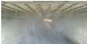
미세 물분사 악취저감시설
