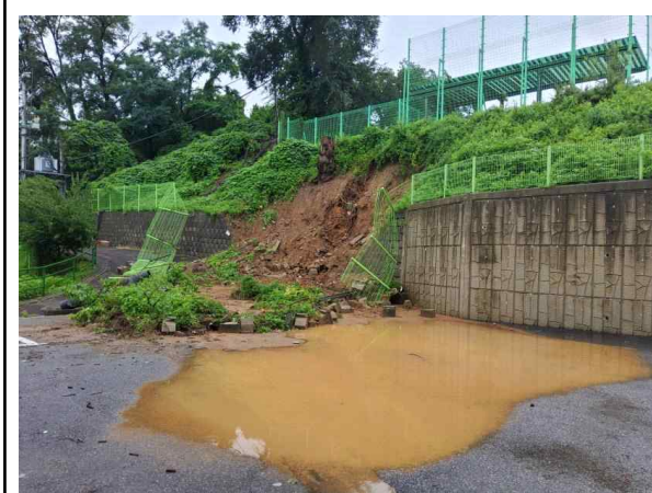
폭우로 인한 축대 붕괴
