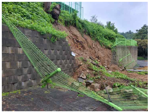
폭우로 인한 축대 붕괴
