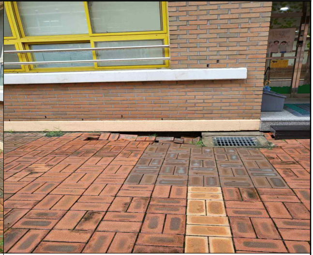
토사 유실로 인한 붕괴
