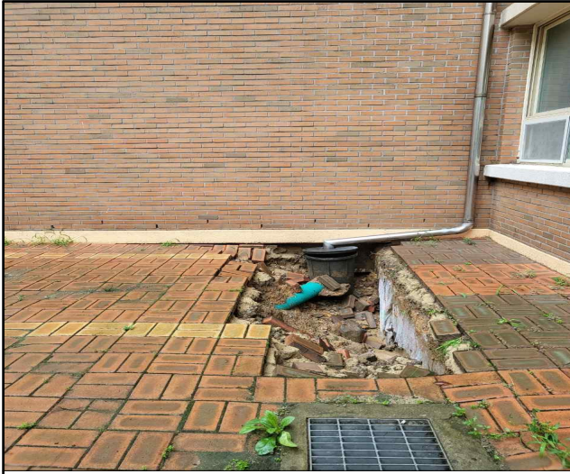
토사 유실로 인한 붕괴
