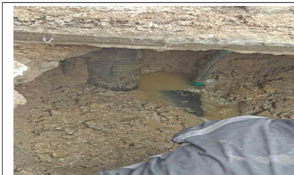
오수분기관 파손 및 연결상태 불량
