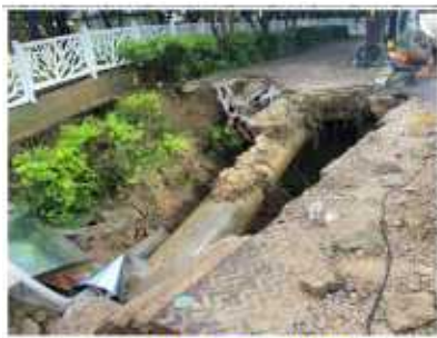
① 하수도관 파손
