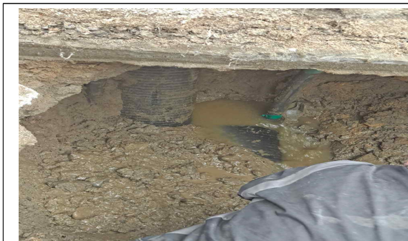
오수분기관 파손 및 연결상태 불량
