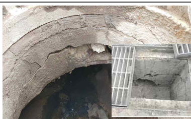
중차량으로 인한 시설물 파손
