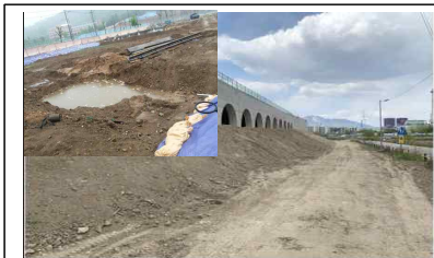
사면 보호시설, 침사지 미설치
