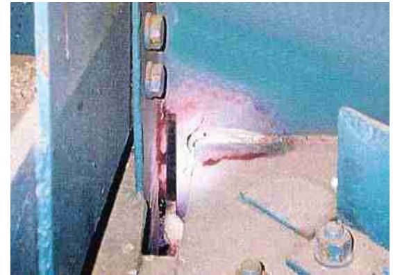
<거세트판 연결 복부판 균열>
