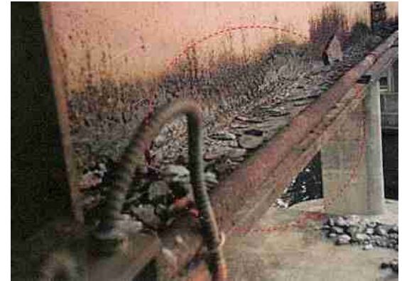
<신축이음 하단 거더 부식>
