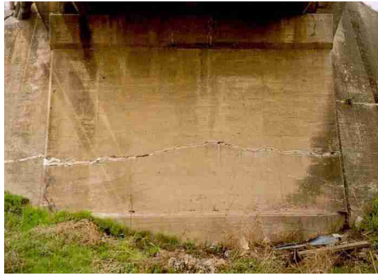
<구체 횡방향 균열>
