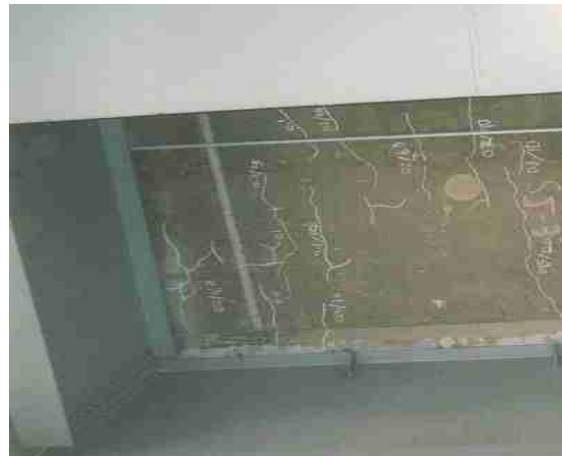
<거더 바닥판 균열>
