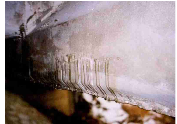
<거더 측면 균열>
