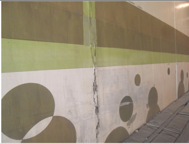
6 정비전(범박터널) - 신축이음부 박리
