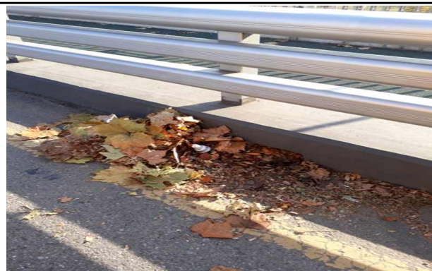
4 정비전(오목교) - 빗물받이 이물질 퇴적
