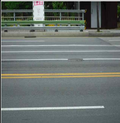
교면포장 - 아스콘 소성변형
