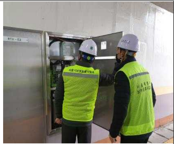
가로등, 터널등 분전함 점검
