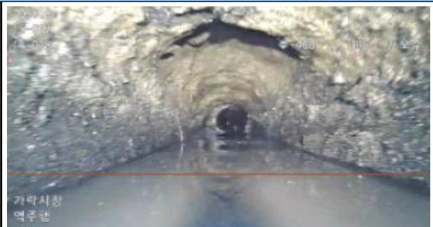
CCTV 조사 : 채소중도매인동 (상단부 관로파손 - 열화부식 콘크리트 탈락)
