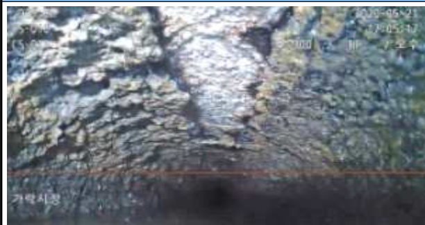
CCTV 조사 : 채소중도매인동 (상단부 관로파손 - 표면파손)
