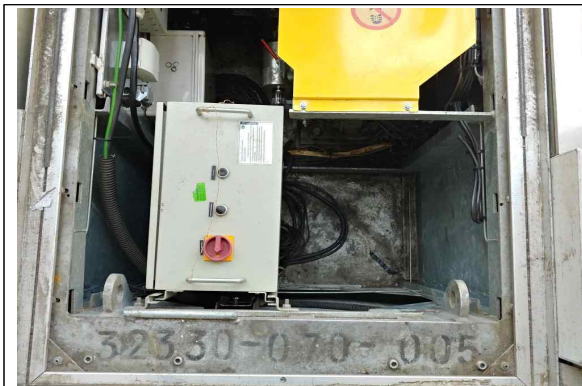
기계실 내부 인버터 설치 가능
