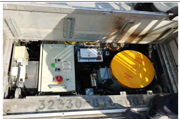
기계실 내부 인버터 설치 불가
