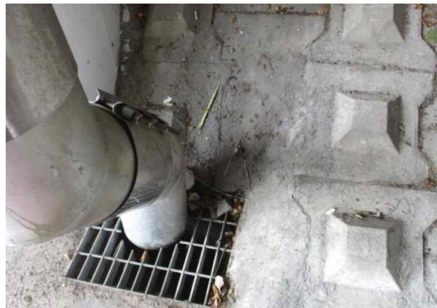
4-1: 장안교:하부 배수로 주변 청소요망
