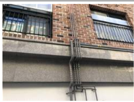
사진21-1. 도시가스 배관 가시철망 추가설치
