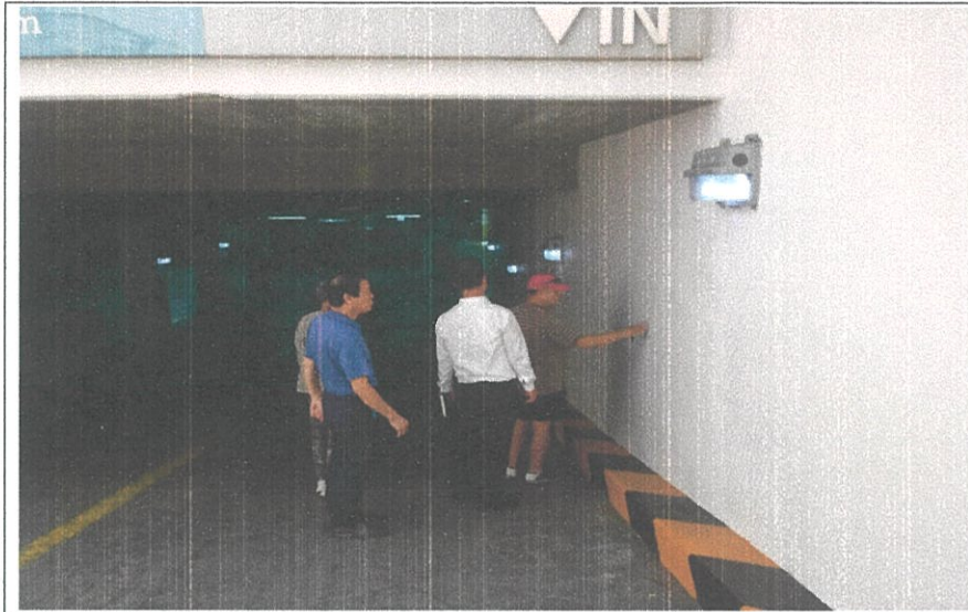
지하주차장 크랙보수 및 누수 검사
