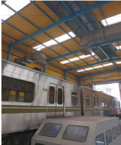
< 전삭고 상부 배기설비 >
