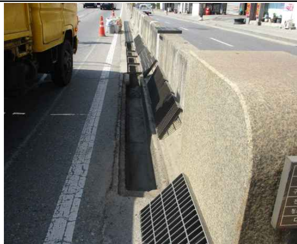
연번 2-1: 배수로 퇴적물
