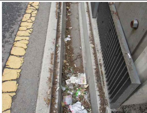
연번 4-1: 배수로 퇴적물
