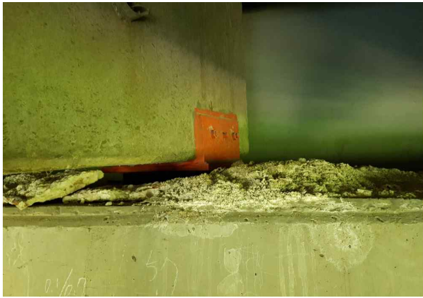
연번1: 대치동측 교대부상단(A1), 콘크리트잔재
