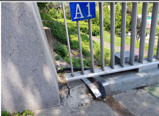
연번3: 대치동방향 신축조인트 덮개파손(A1)
