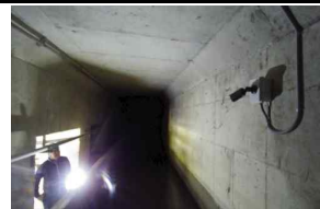
청계천 북개막스 내부 CCTV 설치 : 배오개다리(우), 영도교(우), 성북천(좌), 정릉천(좌)
