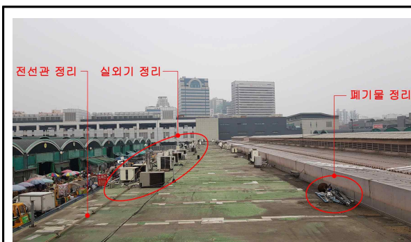
사진6. 지붕위 지장물 현황
