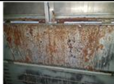
승강로 및 출입문 산화
