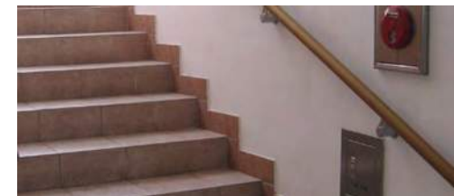
양쪽에 설치된 계단손잡이
