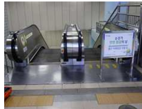
에스컬레이터 교체 전(상부측) (자동운전장치 미설치)
