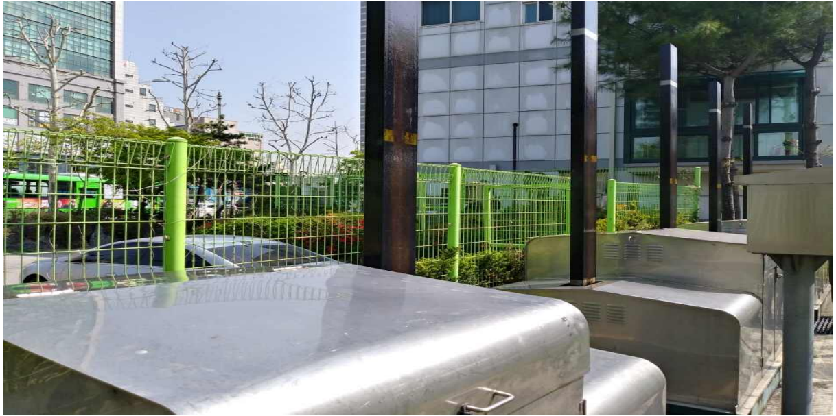
공릉1빗물펌프장 노후 수문시설
