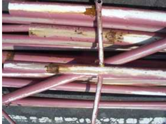
<그림 1-3> 노후 도시가스 배관의 부식 및 가스누출에 의한 교체사례
