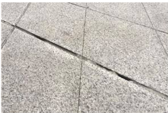
바닥 화강석 줄눈 탈락 발생
