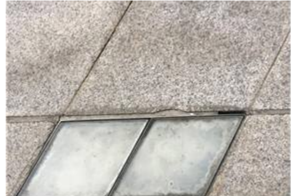
바닥 화강석 줄눈 오염 발생
