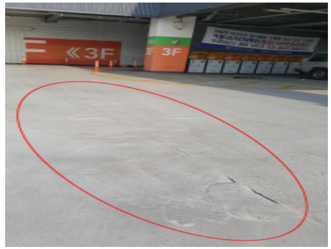
【사진.4】 주차장 바닥용 마감재(우레탄) 들뜸 (가락물 판매동 지상3층 주차장)
