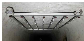
미세 물분사 악취저감시설
