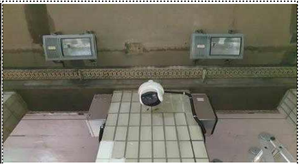
동대문구 신답지하차도 CCTV 카메라(200만화소) 교체 후
