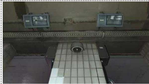
동대문구 신답지하차도 CCTV 카메라(40만화소) 교체 전
